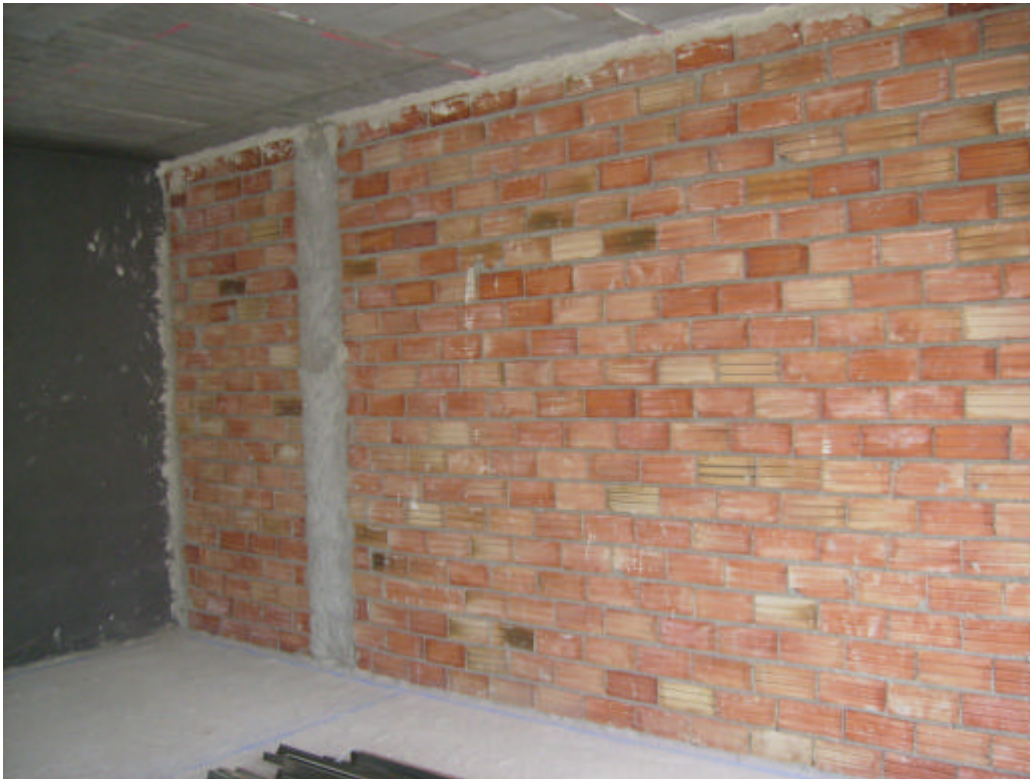
Foto 6: Tabique de ladrillo hueco doble sin enfoscar como elemento base para separación entre recintos de distinto usuario.
